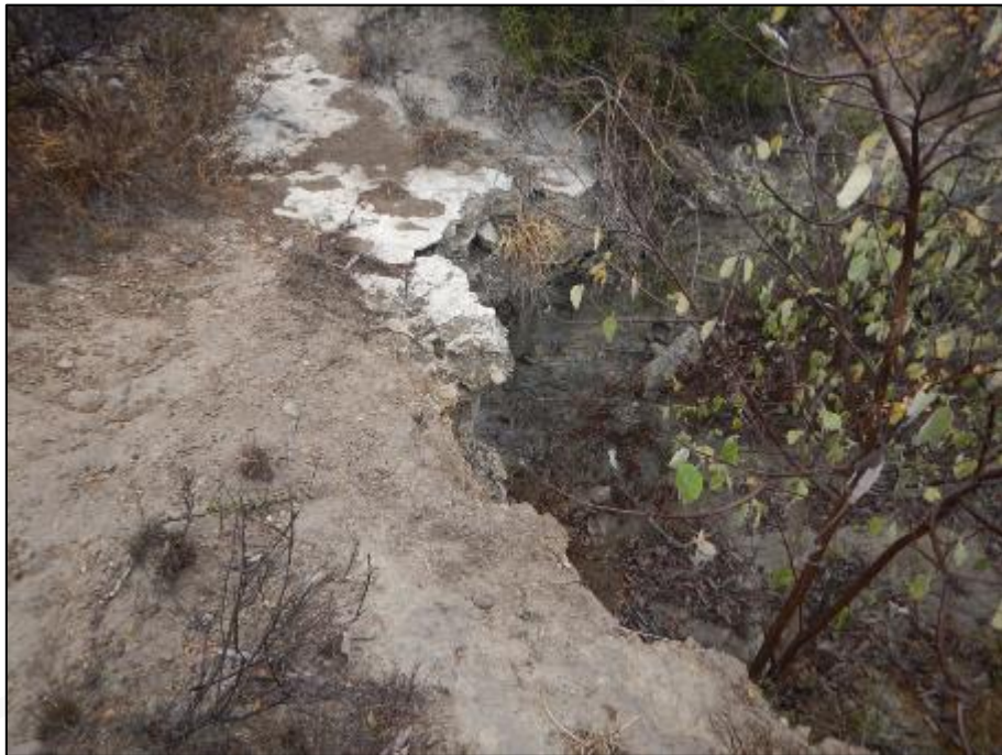
Figura 5-12 Corte abrupto formando una carcava como inicio de los arroyos .
