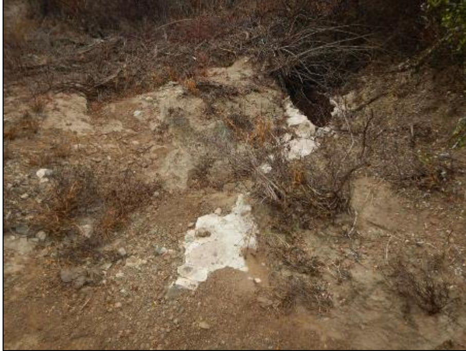
Figura 5-18 Formación de caliche en el predio donde el agua arrastra el material superficial.
